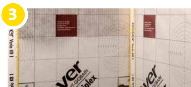
3 Les différents lés de Vario KM Triplex se superposent largement (recouvrements de 15 cm minimum). Un autocollant unilatéral Vario KB1 doit être posé sur les zones agrafées et les raccords entre les lés, afin de renforcer encore l'étanchéité à l'air.
